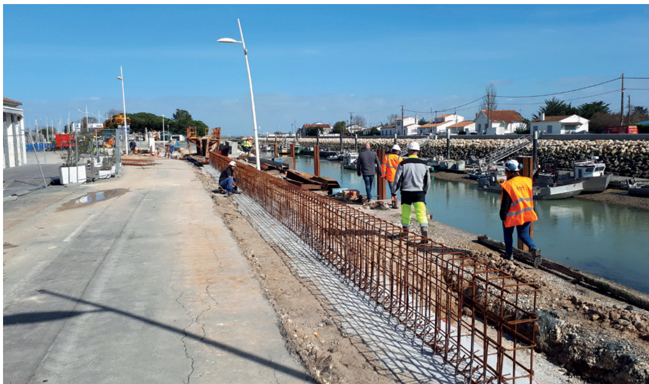
Travaux d'endiguement en 2021 sur le chenal de Boyardville. À l'arrière, plusieurs maisons submergées lors de la tempête Xynthia ont été démolies © CC10
