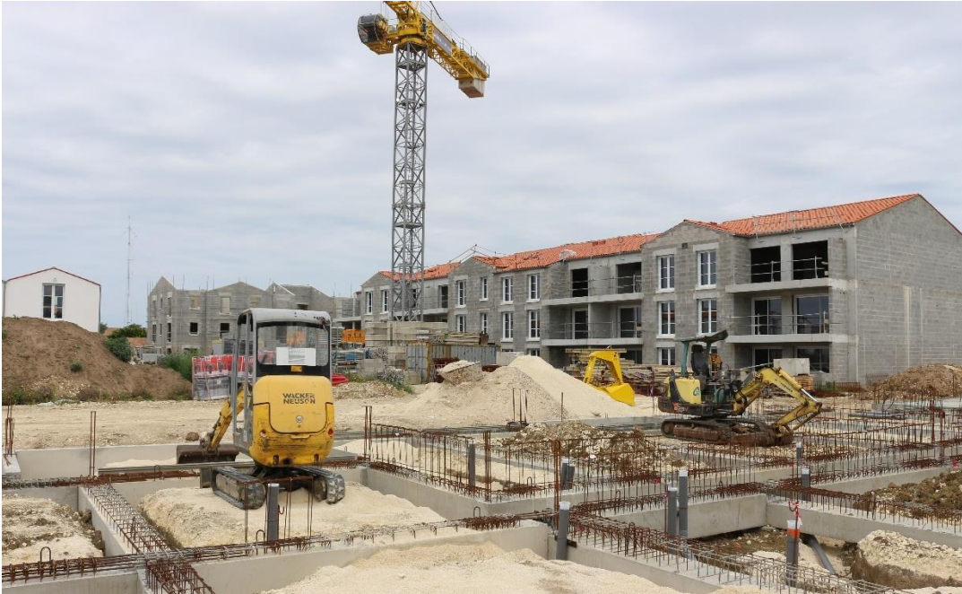
Opération de logements en construction en renouvellement urbain sur la commune de Saint-Pierre d'Oléron -2022 - ©Pôle Marennes Oléron
